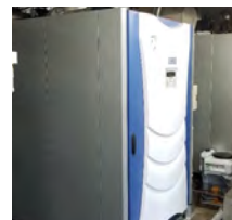
廃食油ボイラー
