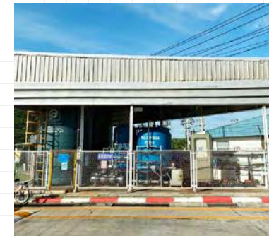
アユタヤ工場の水再生利用設備
