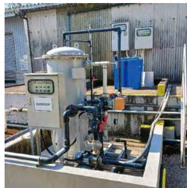
雨水ろ過装置
